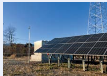
敷地外設置の太陽光発電施設
