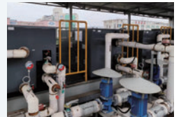
ヒートポンプ設備
