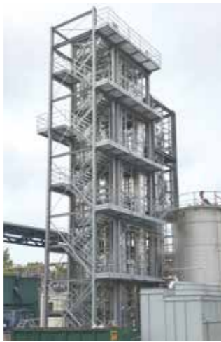
日東ベルギーの溶剤再生設備
