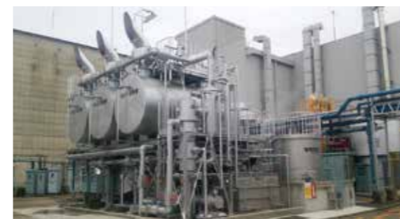
関東事業所へ導入した溶剤回収設備
