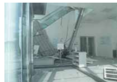
日東電工 東北事業所で、特に被害の大きかった評価棟内。階段の天井一部が落下しました。
