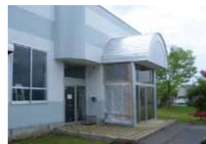
日昌いわき工場。玄関ガラス破損(フィルムで養生部分)
