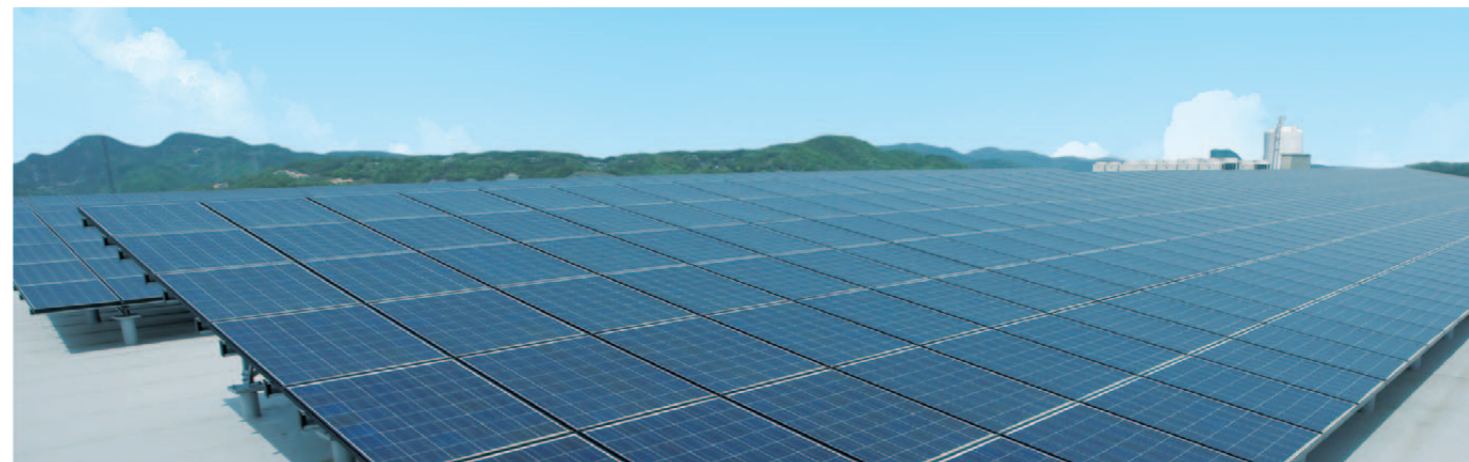
ソーラー発電システム
