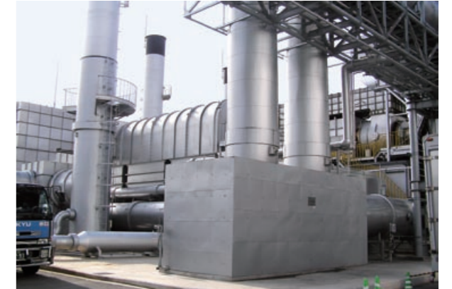
尾道事業所の脱臭炉
