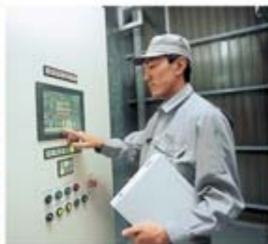
亀山事業所 第9工場脱臭炉
