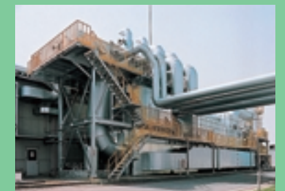
■グループ会社 日東シンコー(株)が設置した脱臭炉
