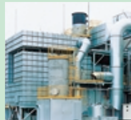
■脱臭炉(廃熱ボイラー付き)
