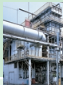
■溶剤回収装置
