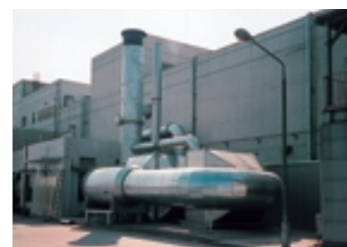
日東電工上海松江(中国)の触媒式脱臭炉
